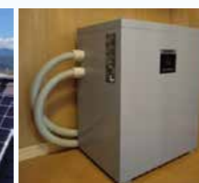
室内に設置した蓄電池
