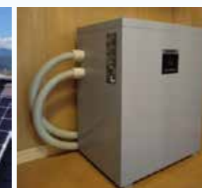
室内に設置した蓄電池
