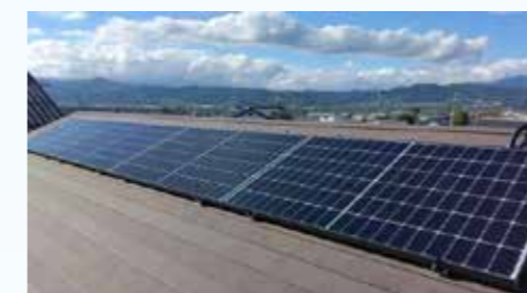
屋根の上に設置したソーラーパネル
