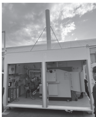
フラワーセンターに設置されたバイオマスボイラー
