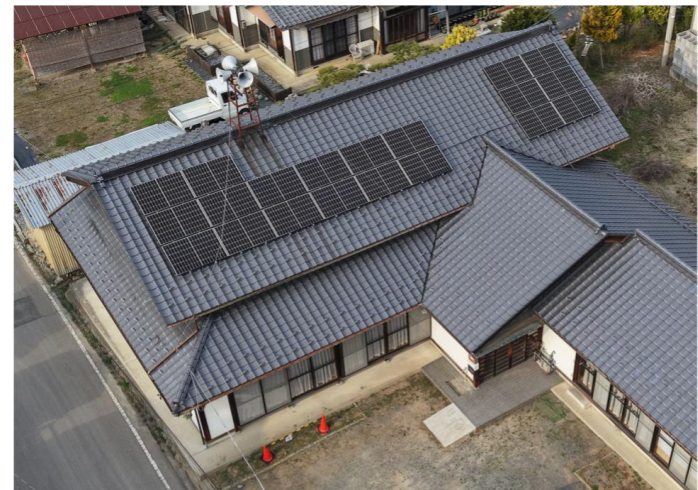
公会堂の太陽光・蓄電池システム（押羽自治会）
