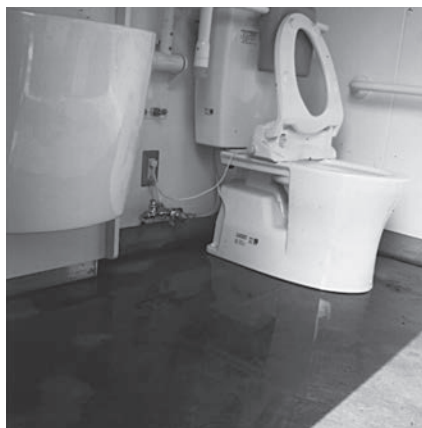
「だれでもトイレ」の床の水溜り
