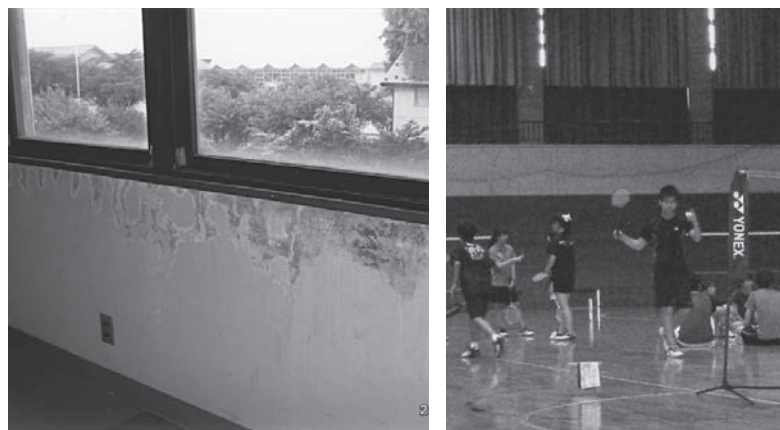
雨漏りの状況（バケツと壁）
