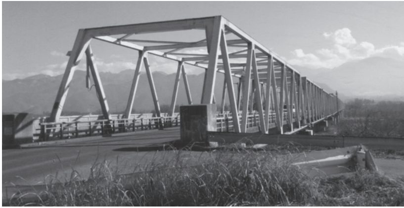
架け替えか補強かの検討時期に来ている小布施橋
