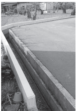
水路を補強したが環境や下流のことを考えれば浸透性の方が良いのでは
