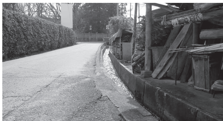
安全対策が急がれる町道22号線
