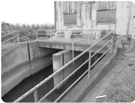
小布施土地改良区第2揚水機場
