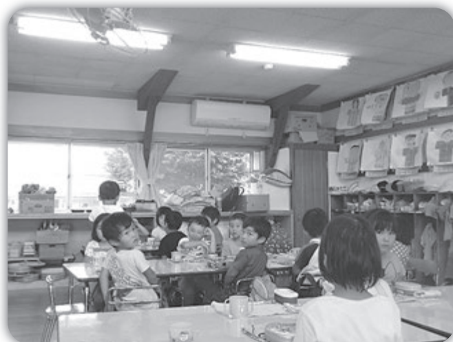
保育園や幼稚園にエアコンが設置されました
